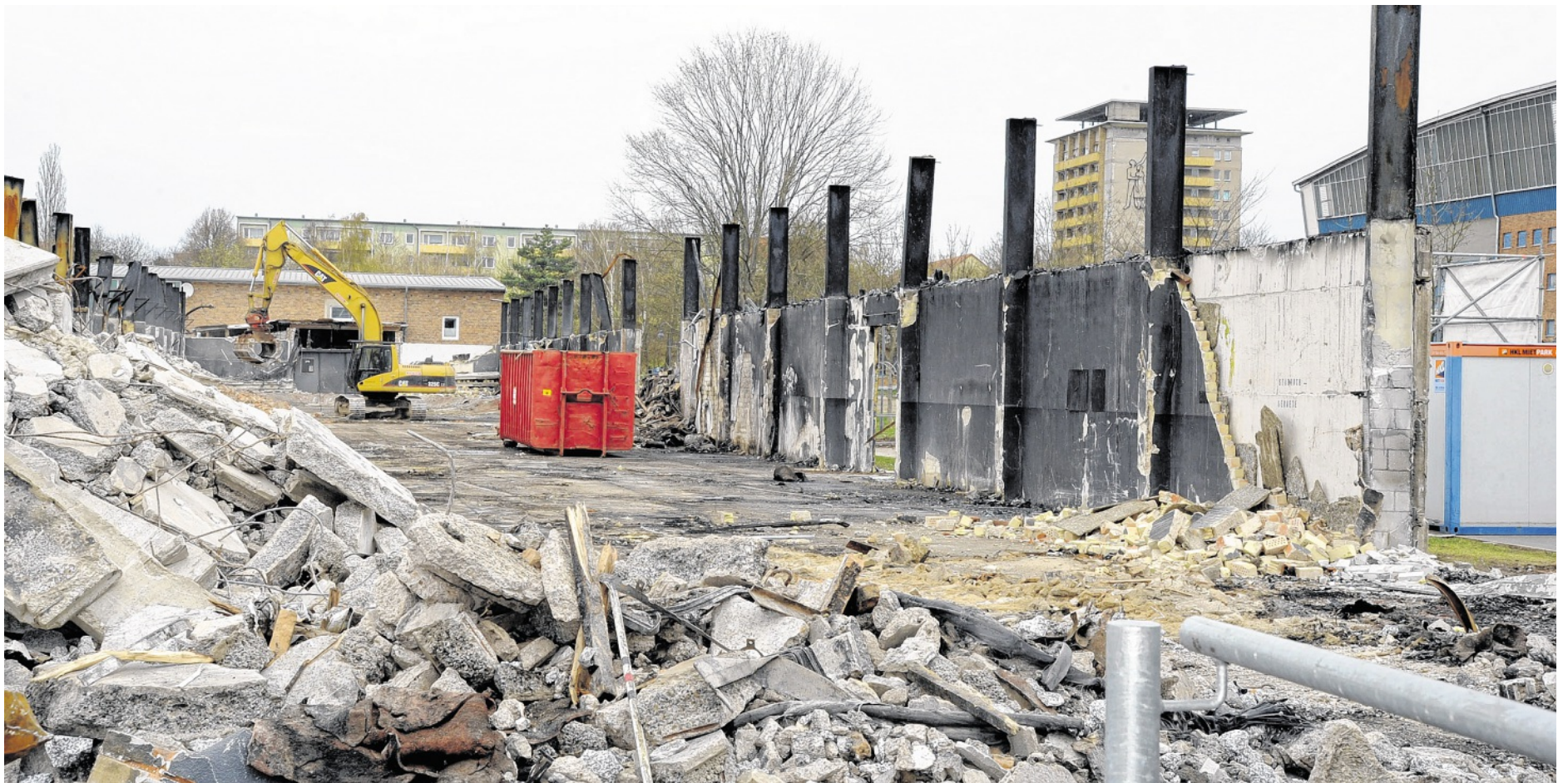
Abbruchfirmen haben mit der Bäumung der Brandruine begonnen, nachdem ein erster Teil der Versicherungssumme dafür ausgezahlt worden war.
